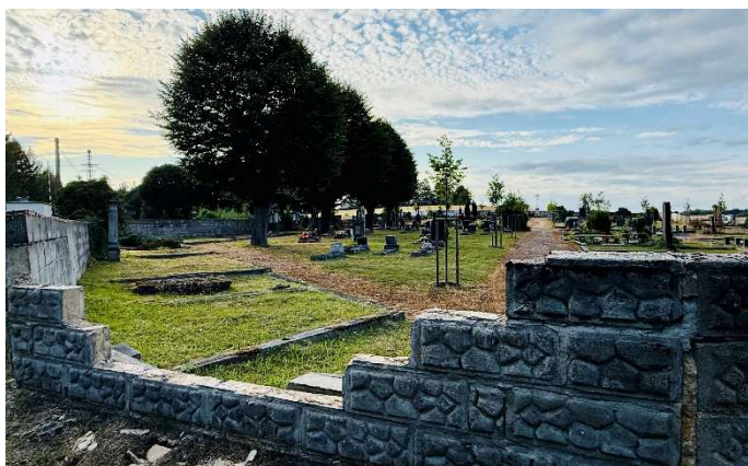
Opravili jsme díru ve hřbitovní zdi, kterou zřejmě způsobily krávy ze sousední pastviny s porouchaným ohrazením.
